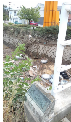
氾濫したあんずホール前の尾米川（R1/10/13撮影）
